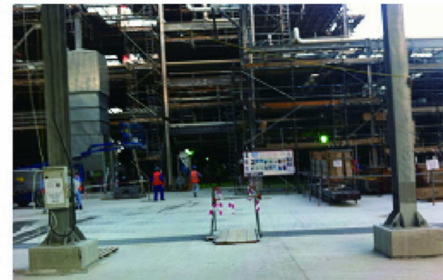
(水沟上钢格栅板缺失,做上钢管硬维护并铺上木板)
